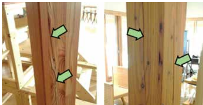
写真3 集成材に生じる「割れ」の例
