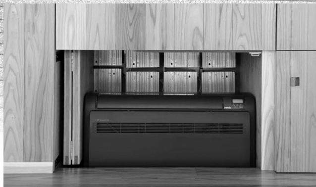
図4 床下に半分埋め込まれた床置きエアコン
