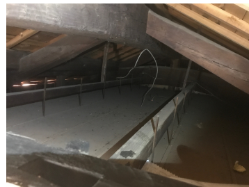
天井裏の無断熱を確認
